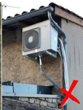
Climatisation disposée de manière inesthétique en imposte, génératrice de bruits
